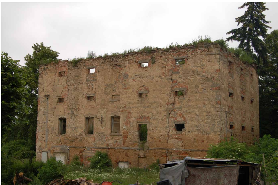
Obr. 9. Tlustec (okr. Česká Lípa), budova tvrze od jihozápadu po zřícení krovu. Stav 27. června 2009.
